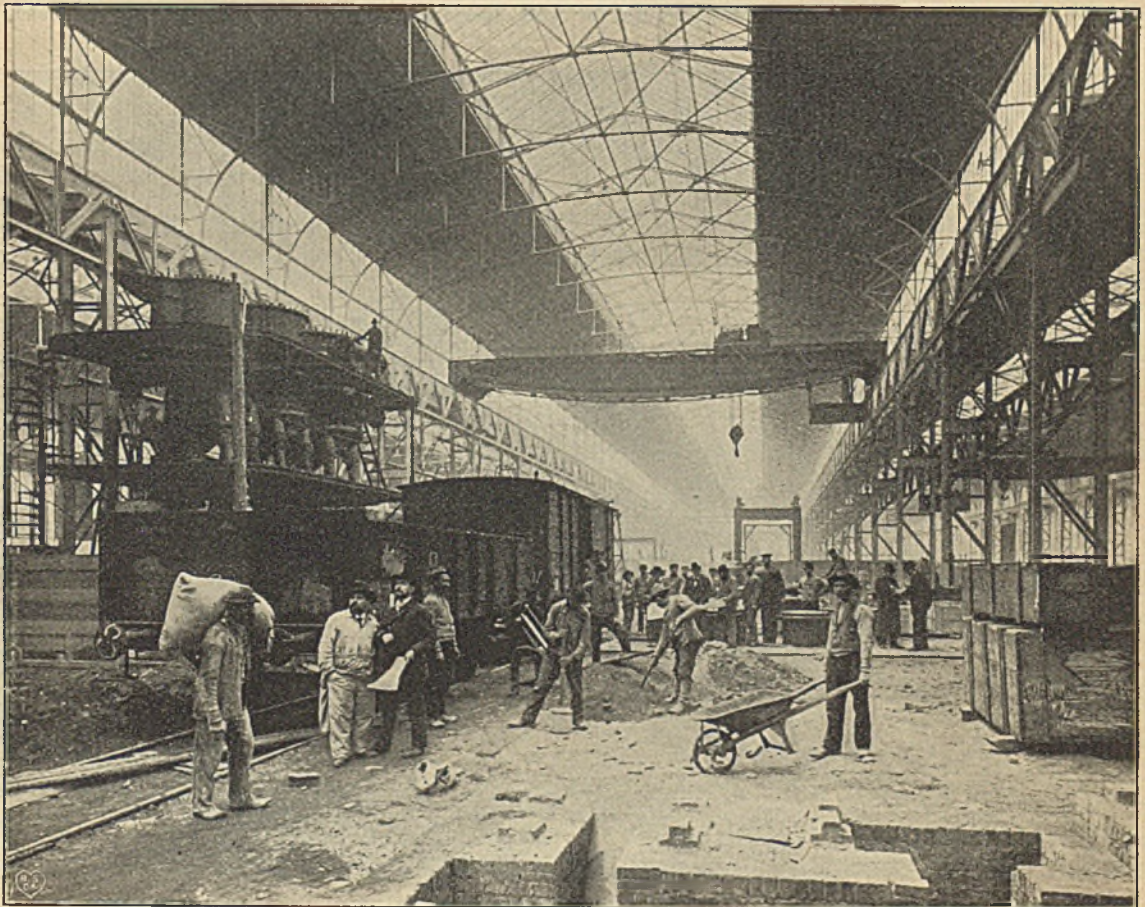
Abbildung 7. Blick in die Maschinenhalle (Aufnahme Anfang März).
