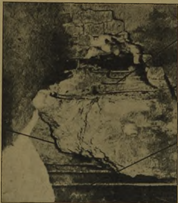
Abb. 8. Aufbiegen von Haken im Ankerbankett. (Abb. 7 u. 8. Folgen unzureichender Bemessung auf Zerrungen.)
