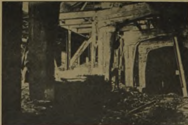
Abb. 9. Rißbildungen an einem Rahmen infolge von Senkungsunterschieden.
