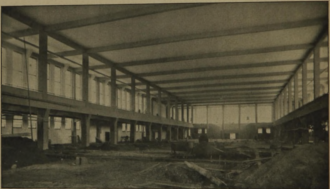
Abb. 10. Inneres der großen Maschinenhalle im Bau. Das Haus der Technik in Königsberg i. Pr.
