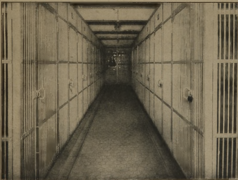
Abb. 11. Hauptkühlraum. Der neue Schlachthof der Stadt Kissingen.
