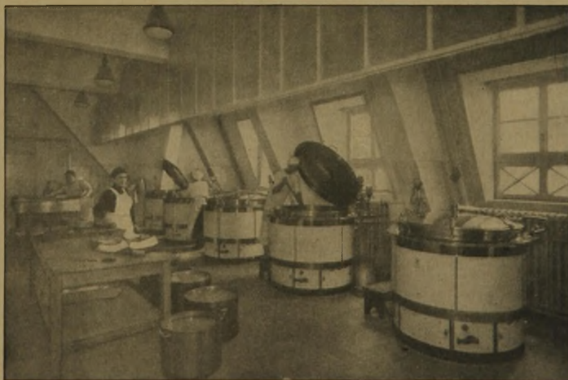
Abb. 36. Verwaltungsgebäude der Hanomag in Hannover. (Vgl. Abb. 33, S. 278.) Blick in die Küchenanlage im Dachgeschoß. Architekt: Carl Ahrend, Arch. B. D. A., Hannover-Linden. Das moderne Industrie-Verwaltungsgebäude.
