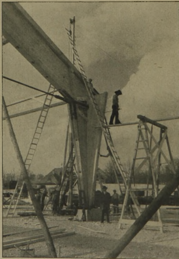
Abb. 9. Montage der Fahrzeughalle X i. Ausstell.-Bahnhof. Arch. Reg.-Bmstr. Harbers, Konstr. Gebr. Hatz, Stat.-Berechnung Ob.-Ing. Gall, (Phot. Stark, München.)
