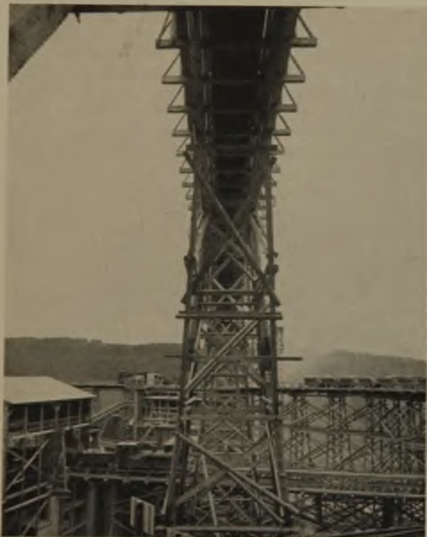
5 Brech- und Mahlanlage für die Betonzuschlagstoffe
