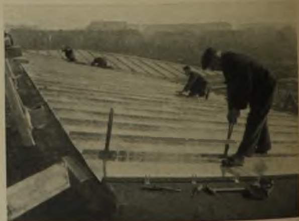
6 Verlegung von Zinkblech nach dem Stehfalzsystem auf dem Neubau des Untergrundbahnhofes Berlin-Stadion
