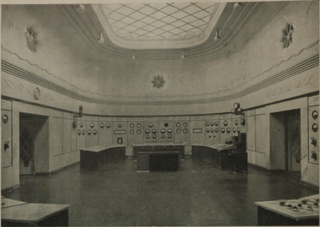
Abb. 6. Blick in den Zentral-Kommandoraum.
