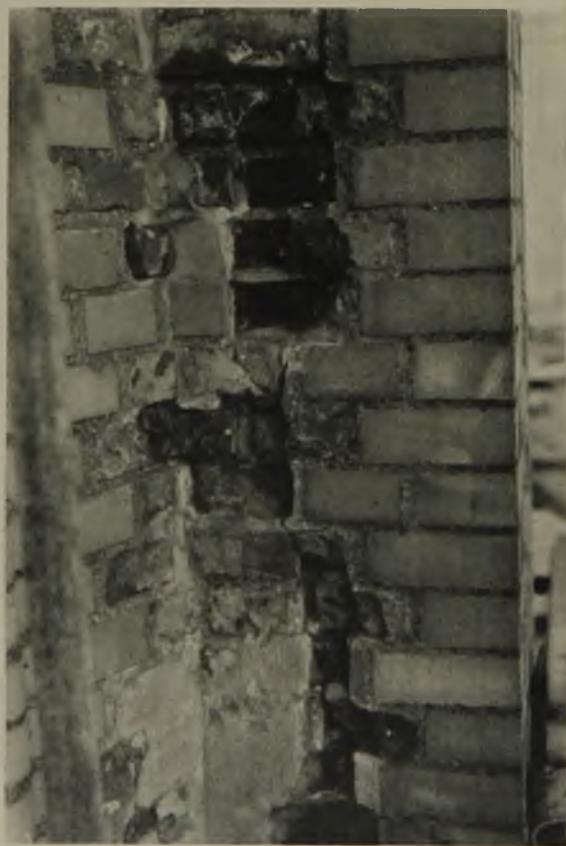
3 u. 4 Verwitterungsschäden a. d. St. Marien-Kirche Königsberg Nm. Stark verwitterter Strebepeiler
