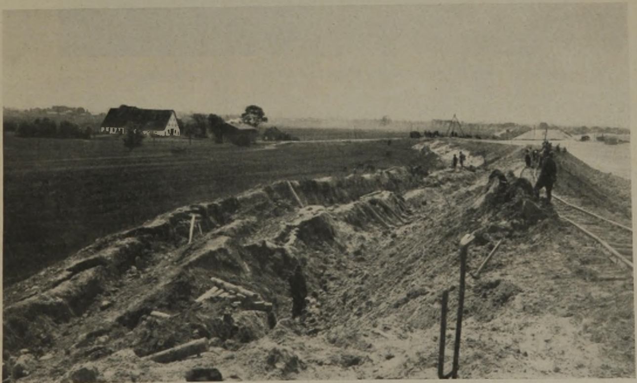
Abb. 12. Rampe der Marschbahn u. d. unteren Ladeweges (nach Süden gesehen). Links vom Damm ab- und hochgedrückte Bodenmassen.
