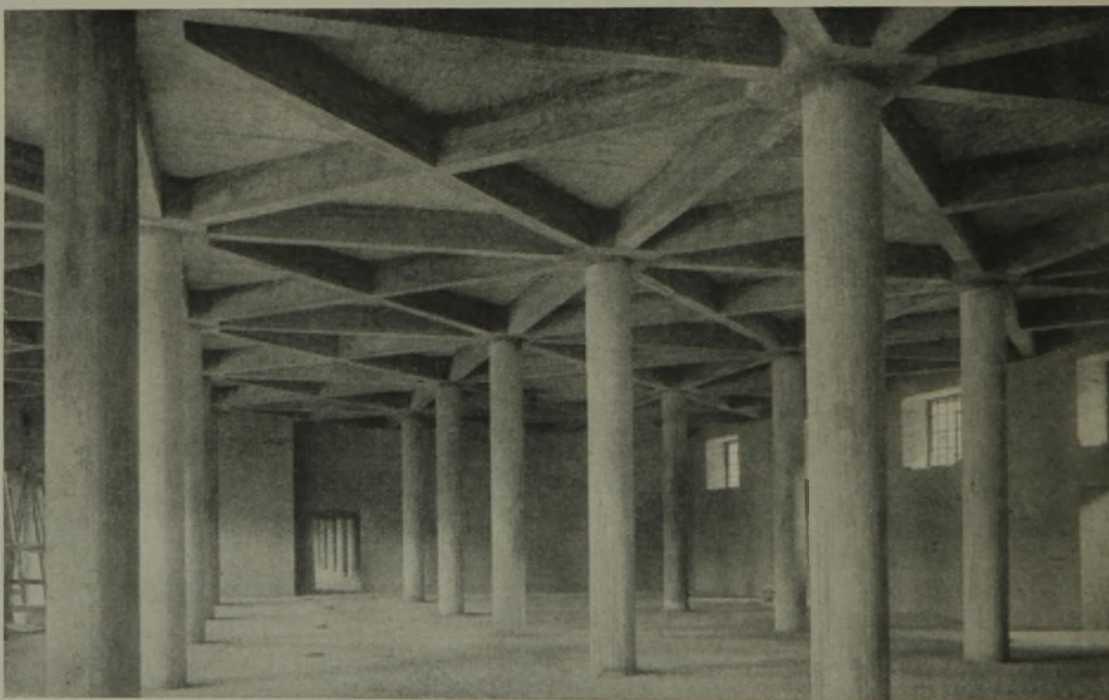
Abb. 11. Zuckerraffinerie Phönix in Kopenhagen, erbaut für die Dänischen Zuckerfabriken A.-G. Ausführung: Christiani und Nielsen, Hamburg-Kopenhagen.
