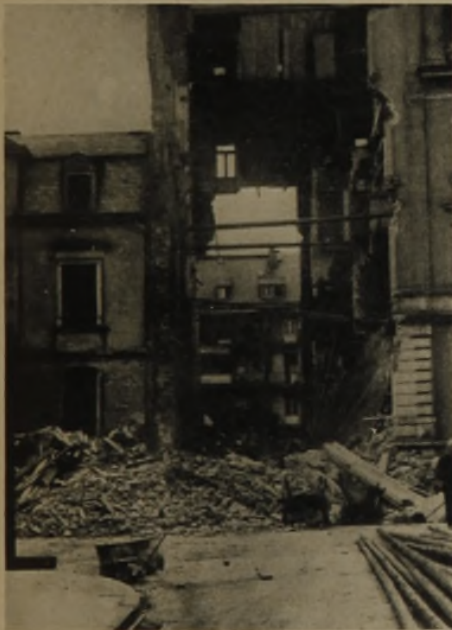
8 Sprengbomben-Wirkung bei anderem Wohnhaus mit schwächeren Zwischenwänden
