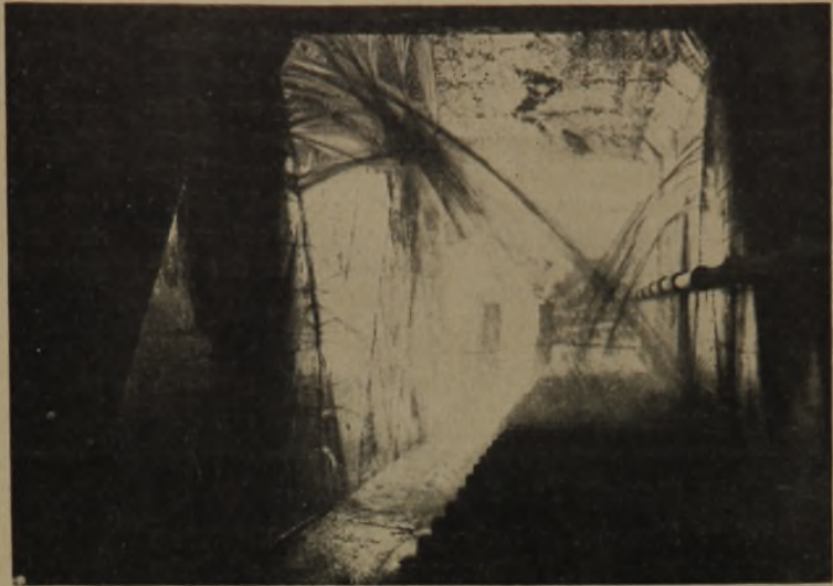
4 Fuge im Umlaufkanal eines Docks in England. Vor der chemischen Abdichtung
