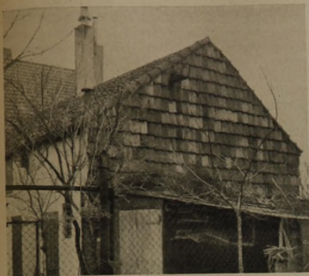
6 Ein ebenso betrübendes Stück Baukultur als Siedlersebsthilfe gegen Bausünden des Architekten (vergl. Bild 5)
