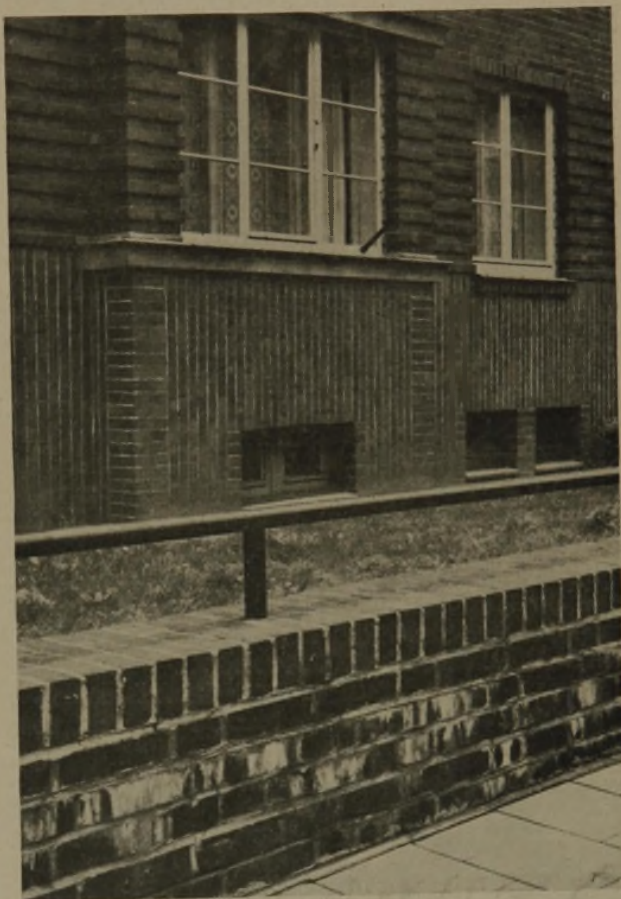
8 Herumproben ist beim Klinkerbau besonders bedenklich. Es ist vorgekommen, daß Sockel wie dieser unter den Fenstern wegen mangelhaften Einbindens viele Meter lang plötzlich herausfiel. Die Fugen der Einfriedigung sind schon stark ausgewaschen
