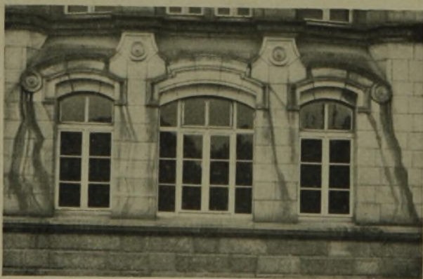
4 Noch so gut gemeinter künstlerischer Schmuck kann erheblich zur Entstellung einer Schauseite aus edlem Baustoff beitragen, wenn handwerklich falsch gedacht und gestaltet ist. Die Triefbahnen des Schmutzes verunstalten den Bau für immer
