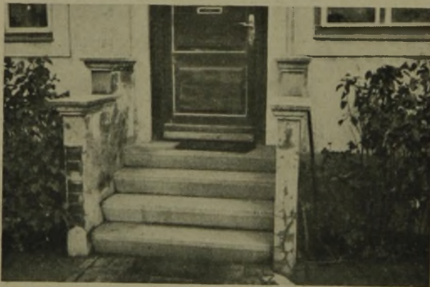
3 Halbsteinige Treppenwange eines Siedlerhauses nach einer Reihe von Jahren. Es gehört nicht viel Erfahrung dazu, ein solches Schicksal vorauszusagen
