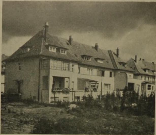
2 Eine Rückseite von Einfamilienhausgruppen. Handwerklich schlechte Einzelheiten (Regenrohre, Schutzdachanschlüsse, Dachvorsprünge, Schornsteinführung usw.)
