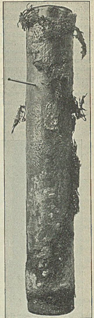
Abbildung 6. Schmiedeeisernes Rohr, Aul- hausen; beginnende Zerstörung.
