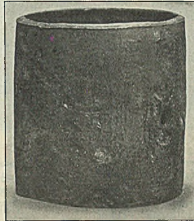
Abbildung 9. Schmiedeisernes Rohr, Wasserwerk Rüstringen bei Wilhelmshaven; 4½ Jahre Betriebszeit.
