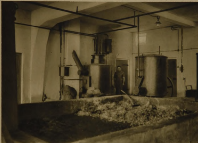
INNENANSICHT DER FUTTERKÜCHE MIT DAMPFERZEUGER, DAMPFÄSSERN UND MISCHWANNE
