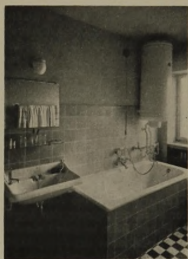
8 Heißwasserspeicher 100 l für Bad und Waschbecken Mittelbach-Siedlung, Düsseldorf
