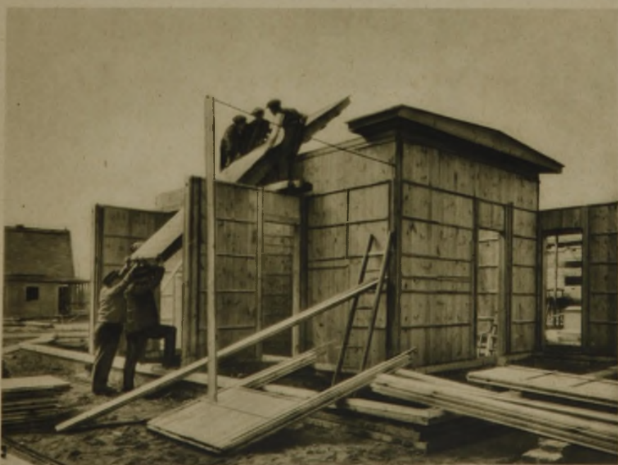
Montage des Hauses Abb. 14. Die Wände des Hauskerns und drei Wände der Erweiterungen (senkrecht gestellte, 10 cm starke Bohlen mit Zugbändern zusammengezogen) sind aufgestellt. Die 2. der in der Werkstatt hergestellten Dachplatten (Konstruktionseinheit) wird aufgebracht
