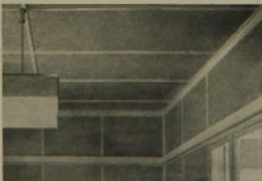
45 Wohnzimmer mit Verkleidung d. Rohrleitungen
