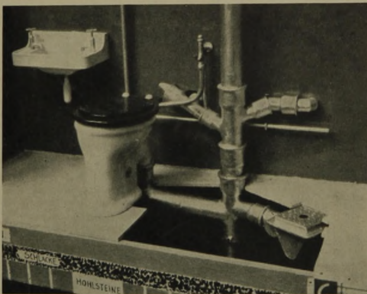
30 Anordnung des Abwasseranschlusses von Klosett und Deckensinkkasten innerhalb der Decke mit Steinbach-Abzweig
