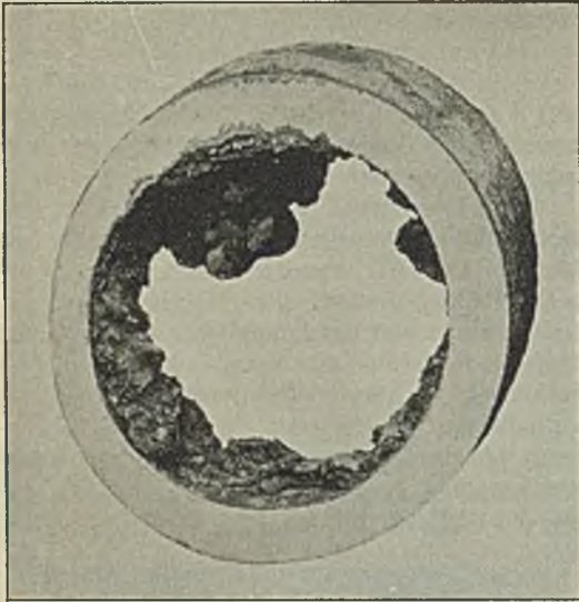
Abbildung 4. Rohrzerstörung mit Ausblähungen.
