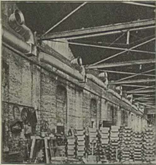
Abbildung 7. Lüftungs- und Luftkühlungseinrichtung.
