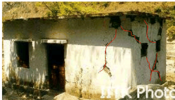
Rys. 2.3. Chamoli, 1999: mały budynek murowy z typowymi uszkodzeniami wywołanymi trzęsieniem ziemi, www.nicee.org .
