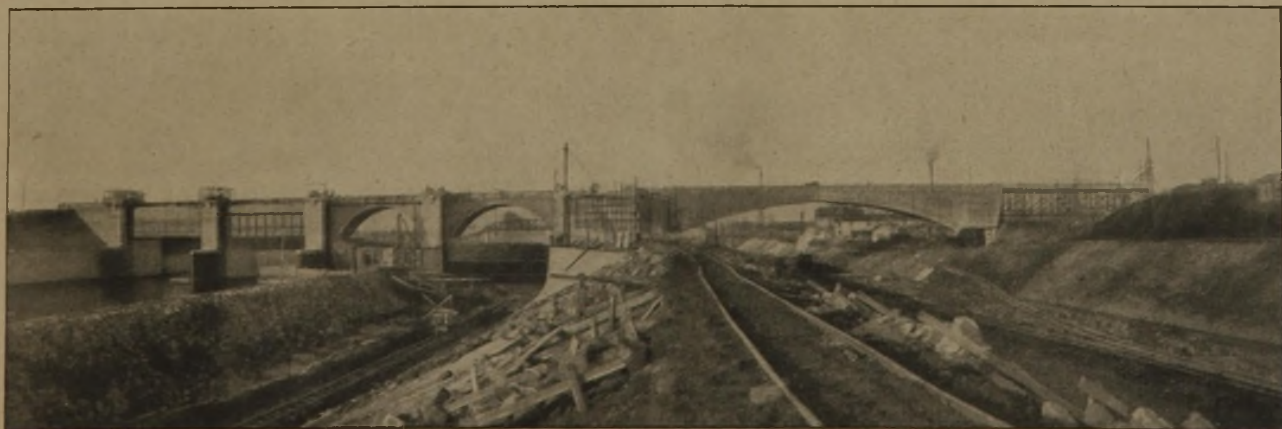
Abb. 1. Staustufe Neckarsulm. Neues Wehr mit 4 Schützöffnungen (Schützen hochgezogen bzw. im Bau) mit gew. Neckarbrücke über Wehr und neuen Schiffahrtskanal. (Stand 22. 1. 25.)
