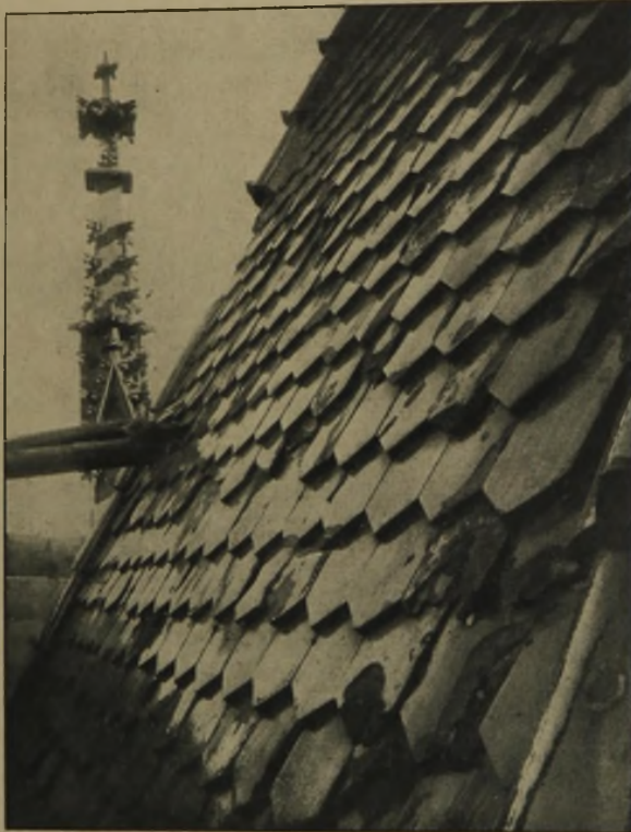
Abb. 2. Zustand des Daches des Mittelschiffes.
