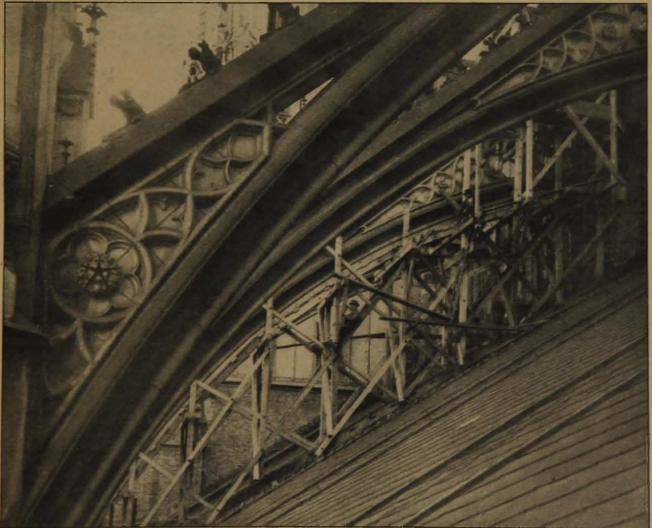
Abb. 1. Unterstützung eines beschädigten Strebebogens an der Nordseite des Hochschiffes.
