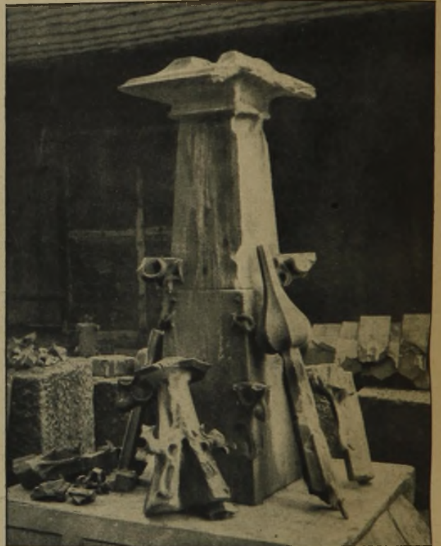
Abb. 3. Zustand einer abgenommenen Fiale.
