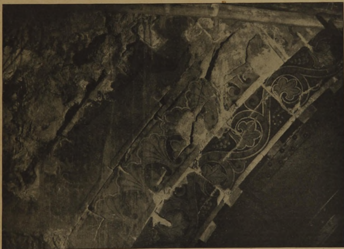
Abb. 7. Zerstörung von einem Vierungsgurtbogen, z. T. in noch stärkerem Maße an den seitlichen 4 Gurtbögen, die die Last von 8000 t zu tragen haben. Darauf auch die eisernen Einrüstungsbögen, die während der Ausführung der Sicherungsarbeiten eine Einsturzgefahr verhindern sollen.
