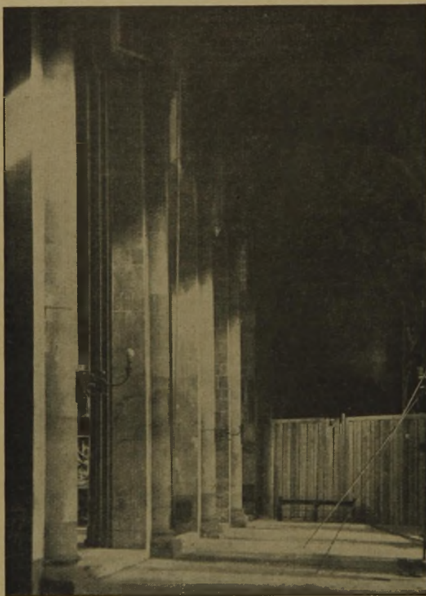
Abb. 2. Wagerechte Ausweichung des nördlichen Seitenschiffs-Zwischenpfeilers. (Vgl. das Lot!).
