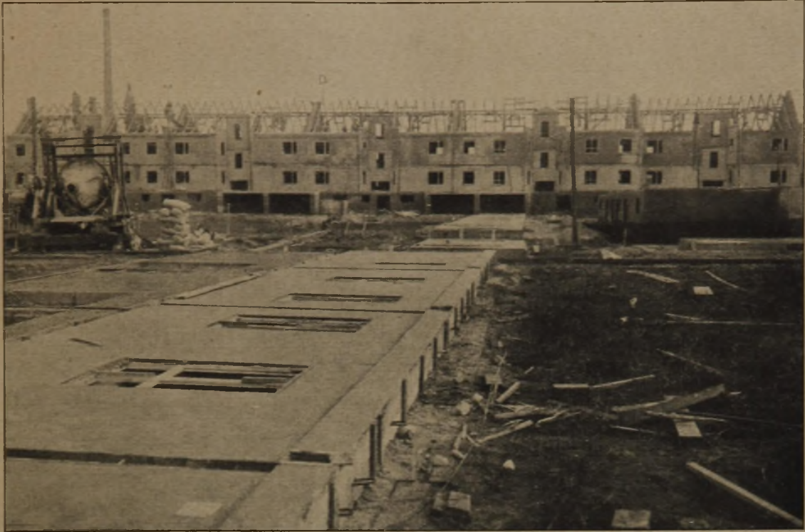
Abb. 3. Im Hintergrund fertig aufgestellte Hausgruppe, links Beton-Mischmaschine. Im Vordergrund Herstellung der Betonplatten mit gleichzeitig eingesetzten Fensterrahmen.
