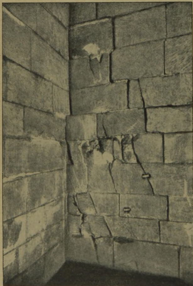
Abb. 6. Rißbildung im Mauerwerk des Kuppelturmes mit Spuren früherer Ausbesserung.
