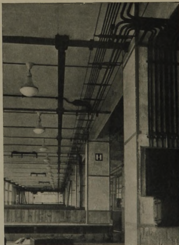
VERLEGUNG DER ELEKTR. STARKSTROMLEITUNGEN. ABB. 20 Die Schwachstromleitungen liegen in einer U-Eisenrinne an der Innenseite jeder Innenstützenreihe
