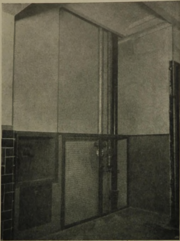
ABB. 15. LEITUNGSSCHACHT IM TREPPENHAUS MIT DRAHTGITTERSCHUTZ
