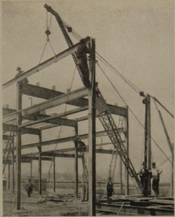
AUFSTELLUNG DER DREISCHIFFIGEN GESCHWEISSTEN HALLE (Die U-Eisen-Pfette wird durch den Kran gehalten, während der Elektroschweisser sie am Stiel befestigt. Auch der Kran ist elektr. geschweißt)
