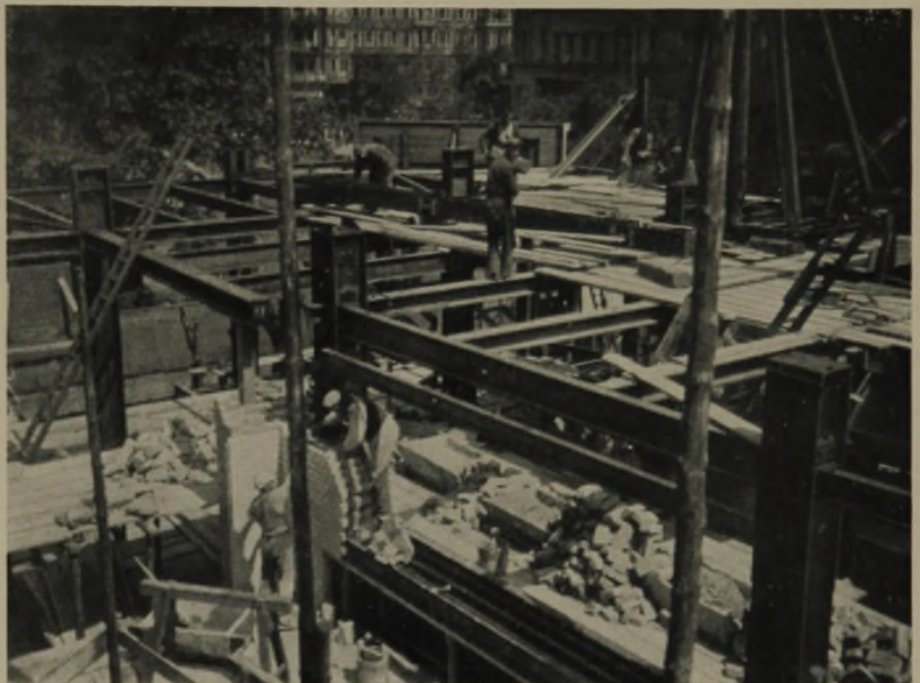
TRÄGERROST VOM HOF GESEHEN 8. 6. 29
