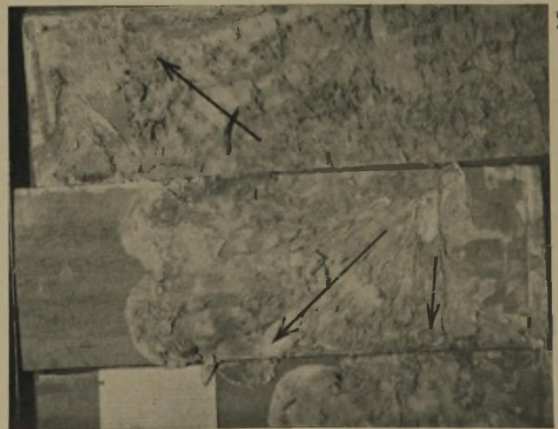
Unterseite von Dielenbrettern mit dem Mycel des echten Hausschwamms. Aufgerissen zeigt es strahligen, radialen Bau. Stränge, die durch Umbildung aus dem Mycel entstehen, sind hier noch nicht zu beobachten, wie auch das Holz noch nicht stark zerstört ist.
