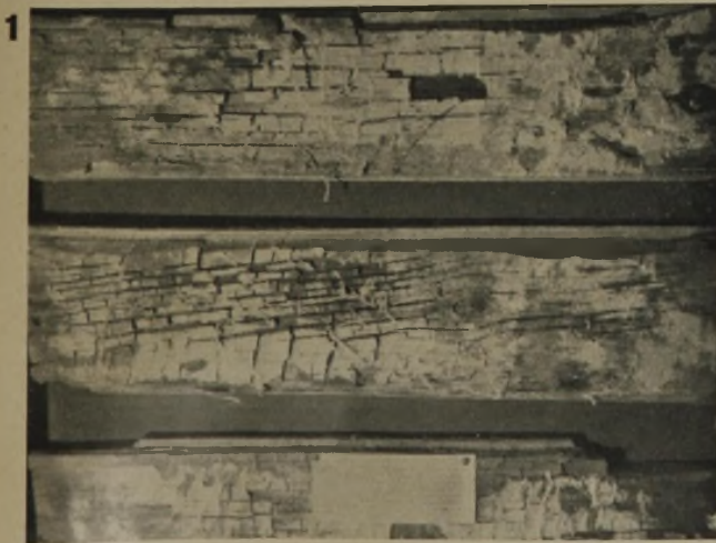
Unterseite von Dielenbrettern, zerstört durch den Porenschwamm. Das Weiße ist das Ernährungsgewebe (Mycel) des Pilzes, die Verästelungen sind die sogenannten Stränge.
