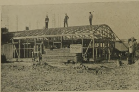
Kohlscheune. Arch. BDA Bruno Ahrends Holzskelett mit Dach in Zollbauweise. Verkleidung mit Tektonplatten
