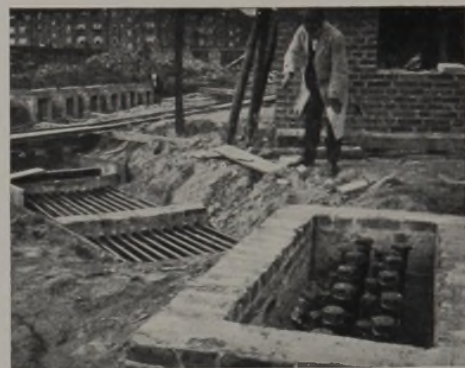
Röhrenleitung von der Füllzentrale zu den zwölf Tanks bzw. zu den zwölf Zapfstellen.
