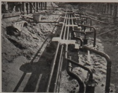
Gesamtlänge der Röhrenleitung 27 m. Blick vom Ende des Rohrnetzes, das sich unsichtbar unter der Erde hinzieht.
