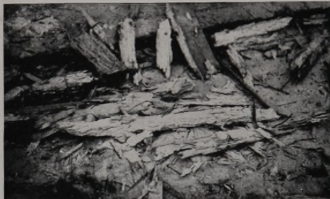
Abb. 3. Die Larven des Hausbocks ließen nur geringe Reste der Balken zurück.
