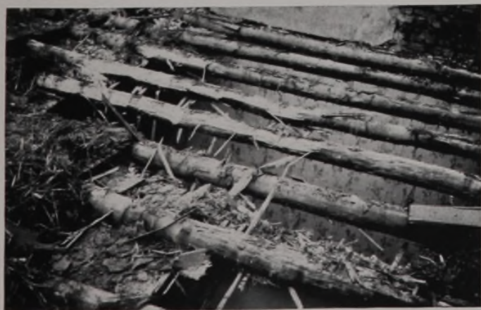
Abb. 2. Völlig zerstörte Decke.
