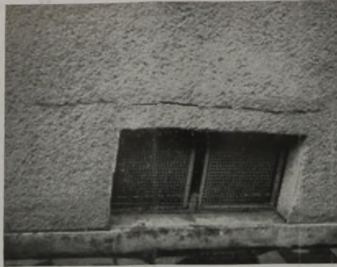
Abb. 1. Riß zwischen Fenstersturz aus umhüllten Stahlträgern und dem oberen Kalksteinmauerwerk; mit der Lupe sind weitere Risse oberhalb des Sturzes zu erkennen.
