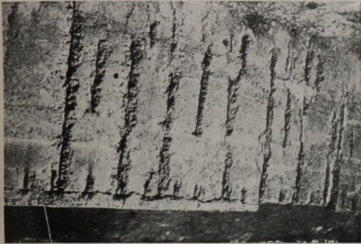
Decke über den Roststäben abgesprungen. Eisen liegen bereits frei.
