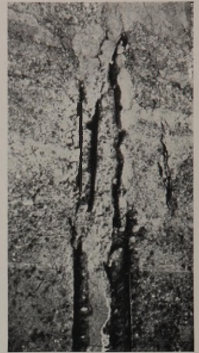
Fortschreitende Zerstörung. Unsichtbar arbeitender Rost. Siehe Kleinrisse.
