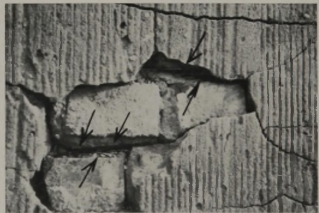
Abb. 3. Sichtbare Bandeiseneinlagen und die Sprengwirkung des Rostes. Der vorher gut haftende, aber wenig dichte Putz hat an den linken beiden Köpfen die Steinflächen mitgerissen.
