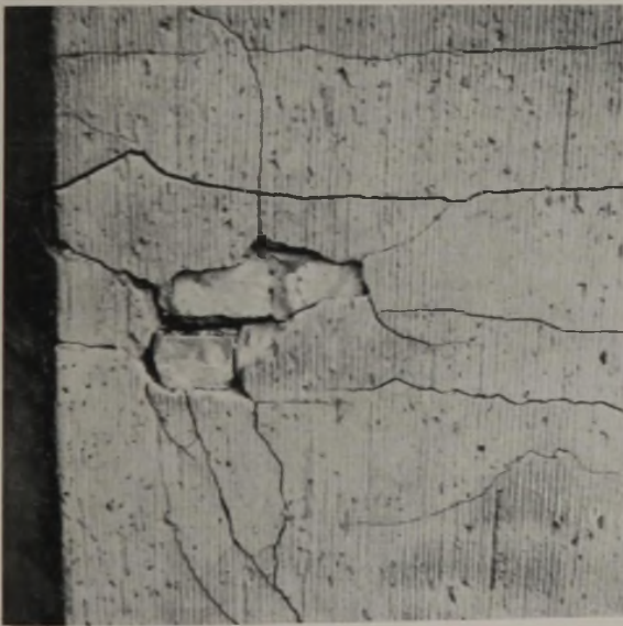
Abb. 2. Ausweichen der Mauerecken durch Rost und Dehnungsspannungen. Abgelöster, hohl liegender Putz.
