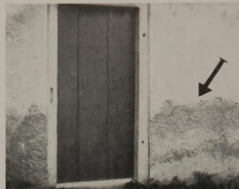
Abb. 1. Zerstörung der Isolierwerte der Stallwand und Schädigung des Viehes.
