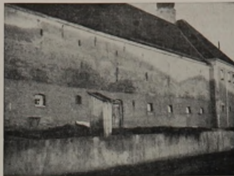
Abb. 8. Typisches Beispiel eines feuchten und denkbar ungesunden Stalles. Die 65 cm dicken Wände dieses alten Klosterstalles bieten wohl einen sehr guten Wärmeschutz, die Feuchtigkeit ist darauf zurückzuführen, daß die Horizontalisolierung fehlt und in dem stark belegten Stall überhaupt keine Lüftung vorgesehen ist.
