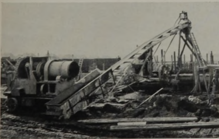
Eine gutgeleitete Baustelle sollte niemals ein Chaos von derartig durcheinanderliegenden Baustoffen, Gerüsten, Schutt und Boden aufweisen, obwohl es sich nur um Betonmischer und Förderband für kleineren Betrieb handelt. Der Polier hat die Pflicht, Ordnung zu schaffen und ist vom Bauleiter anzuhalten, um auch geringere Verletzungen zu vermeiden.
