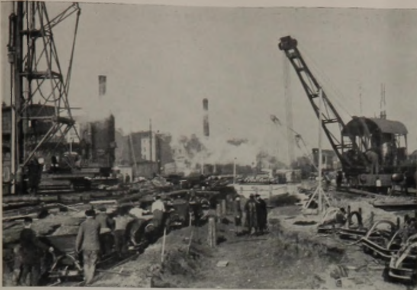
Auch diese Großbaustelle mit Dampfkränen, Baggern und Kranen läßt leider genaueste Ordnung vermissen. Die Boden- und Schuttbestände im Vordergrund sind Gefahrenquellen im Wagenbetrieb und Anfuhr der schweren Baustoffe auf der Anfahrtsstraße. Hier haben Chefbauleiter und Unterbauleiter einzugreifen.
