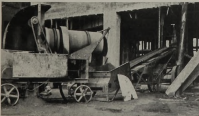
Abb. 2. Kürzeste Transportwege des Mischgutes. Mischtrommel mit unmittelbarer Entleerung in den Trichter des Förderbandes. Sauber gehaltene Umgebung, daher wirtschaftliche Arbeit.
