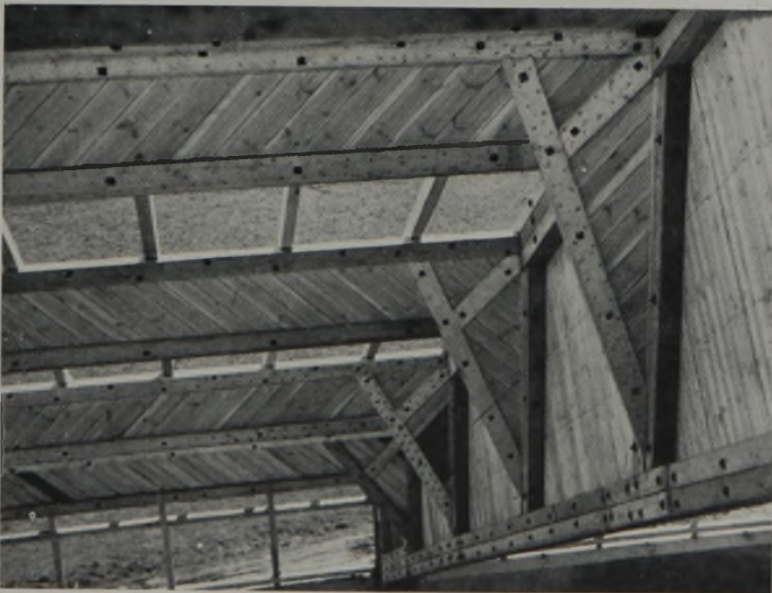
Abb. 4. Teilansicht des verholzten und genagelten Vollwandbinders mit dem kopfbandartigen Pfettenansatz in gleicher Ausführungsweise, die Kanthölzer in den Knotenpunkten zimmergerecht durch Versatz oder Zapfen verbunden. Da bei den doppelten Binder-Kanthölzern Holzdübelverbindungen nicht sichtbar sind, werden Einpreßdübel (Geka-Dübel oder Krallenbänder) zur Aufnahme der Querkräfte und gegen Ueberschreitung der zulässigen Spannungen in den Fugen verwendet worden sein.
