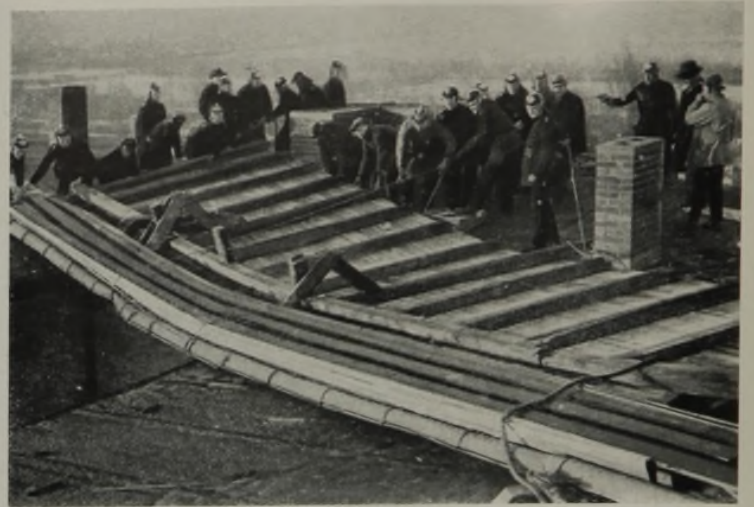
Abb. 2. Blick auf die Dachseite an der Davoser Straße nach dem Sturm. Die Dachfläche, gut gearbeitet, wurde infolge unzureichender Verbindung umgekehrt.
