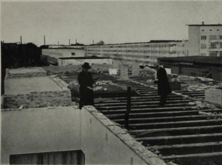
Abb. 1. Das vom Sturm abgedeckte Plattdach in der Davoser Straße 75, 77, 79 (nach den Aufräumarbeiten der Feuerwehr). Links die gesimslose Feldseite mit Erkerbauten. Auf die Entfernung von einem Erker bis zum nächsten entfielen vier Drempe-(Binder-)Stiele, aber nur zwei Stielanker.
