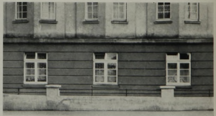
Abb. 4. Falsche Behandlung des Putzanschlusses oberhalb des Gesimses. Typisch für weitausladende Gesimse, vor allem für die bis vor kurzem so beliebten Betonplatten als Schutz über Hauseingängen und Terrassen.
