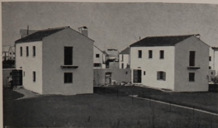
Typ HH. Wohnhäuser durch scheinbare Hofmauern verbunden. Drempel und Fenstereinschnitte unterm Dach von unharmonischer Wirkung. Fensterläden kommen noch. Dach unzureichender Schutz gegen Giebel-Durchfeuchtung.
