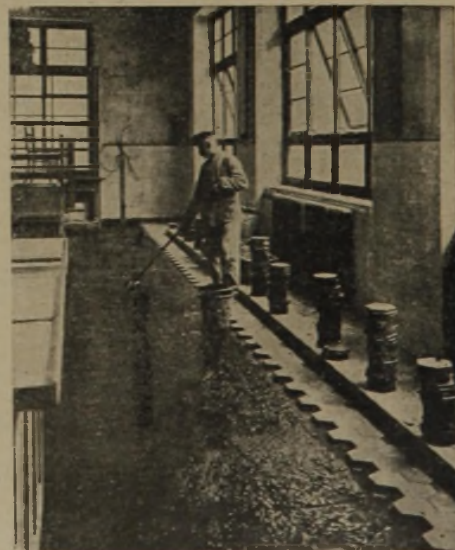
3facher Aristogenisolieranstrich (1 x Aristogen pur, 2 x Aristogenstreichmasse) auf einer Eisenbetondecke unter einem Fußbodenplattenbelag
