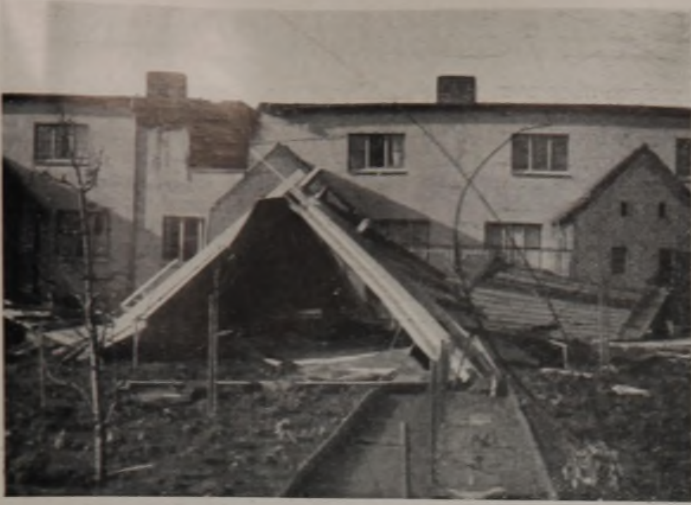
Die Dachflächen haben sich vollständig überschlagen. Die sichtbaren Rinnen mit Dachüberstand und Gesimsverkleidung gehören an die Straßenseite. Der Bruch der Fläche ist auf dem Dach an den Schalstößen erfolgt. Die kleinen Pfosten waren die einzige Befestigung des Daches mit den Deckenbalken. Die Zapfen sind ausgerissen.
