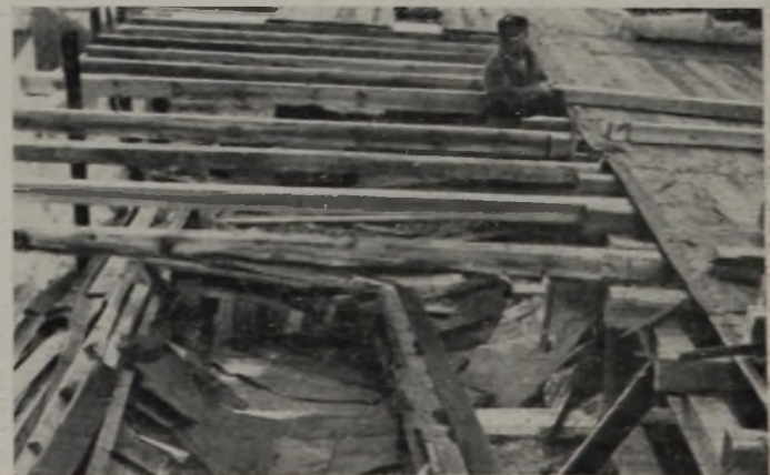
Verwendung von Mauerlatten, aber ohne Verankerung. Die halbe Ueberblattung ist nicht ausreichend. Feuchtes, astreiches und schon stockiges Holz mit blauen Farbstellen als Fäuleansatz, weil der Hohlraum zwischen Balkenlage und Dach keine Durchlüftung enthält. Sparren zu schwach dimensioniert bei Flachdach. Bruchige, genagelte und in der zweiten Lage an den Stößen geklebte Teerpappdeckung minderwertiger Ausführung, Stöße wenig versetzt bzw. überdeckt. Minderwertige Deckenausführung ohne Schuttbeseitigung.
