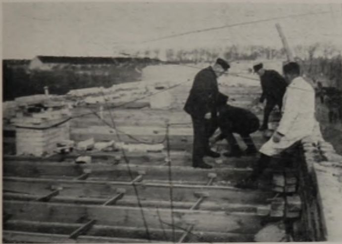
Man beachte die dünnen Längslatten, als Mitträger der Leichtplatten auf Querlatten in primitivster Weise gefestigt, letztere mit kleinem Knaggen und sage und schreibe einem Nagel geheftet, die Latten teilweise noch gestückt, Pfscharbeit! Schornsteindichtungen bei Flachdach nur mit ausgesetzten Schichten und ohne Metallfugenanschlüsse sind vorsätzliche Pfscharbeit. Sparren auf der ganzen Länge ohne Mittelunterstützung.
