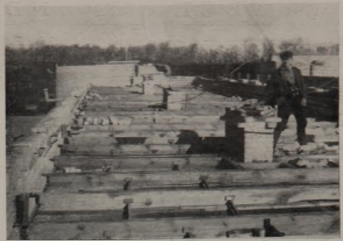
Toter, nicht zugänglicher Raum ohne Entlüftung zwischen Balkendecke und Dach. Feucht gewordenes, minderwertiges Tannenholz mit losen großen Aesten, im Auflager mangelhaft karboliniert. Auf der ganzen Länge nur zwei Balkenanker sichtbar. Dachsparren mit Ueberstand ohne Mauerlatte, Befestigung und Verankerung mit dem Mauerwerk.
