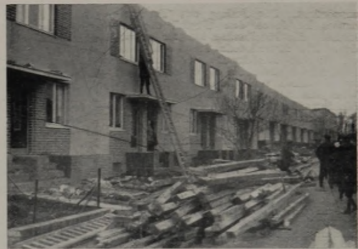
Angriffsfläche des Sturmes am Dachüberstand der Firstseite. Sichtbar nachlässige Holzverbindungen an den gestapelten Hölzern. Sparren zum Teil wegen fehlender Mittelunterstützung gebogen und gebrochen, am Auflager wegen fehlender Mauerlatte ohne Ueberblattung bzw. Ueberkämmung, siehe auch gleichmäßig stehengebliebene und wenig beschädigte Wände. Keine Maueranker.
