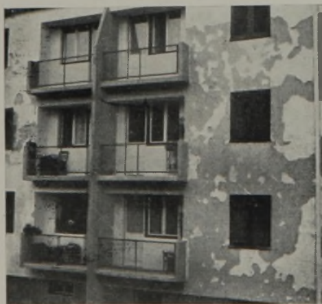
Verputzschäden durch zu frischen pulverisierten Sackkalk. Fotos: Schreiber.
