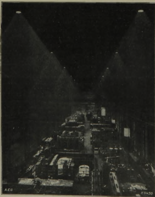
Abb. 13. Beleuchtung einer Montagehalle mit Tiefstrahler-Armaturen nach Abb. 10
